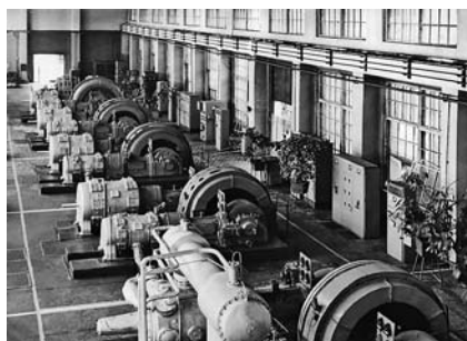
Компрессорная станция шахты «Капитальная № 2»
