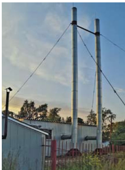
Газовая котельная на «Токаревке»
